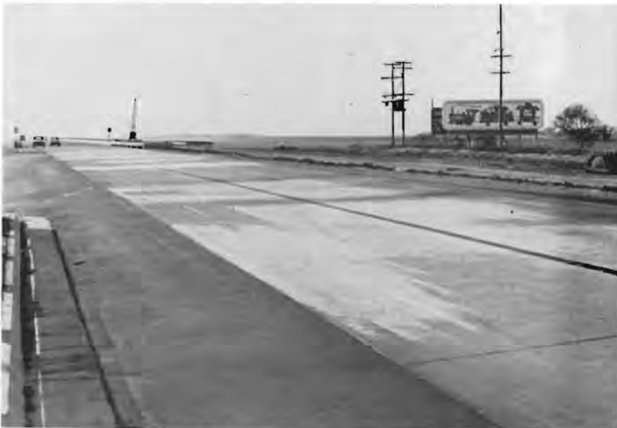
Bild 54: Abgeschliffene Decke mit schlechtem Aussehen
