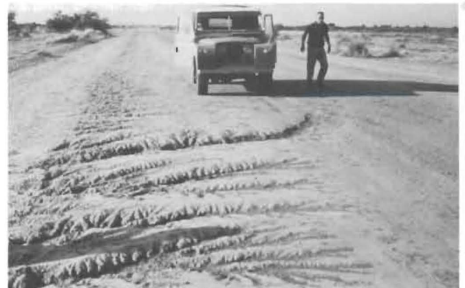
12: Erosion in Straßenschultern und Auswaschung der Bankette (Norden von Tschad)
