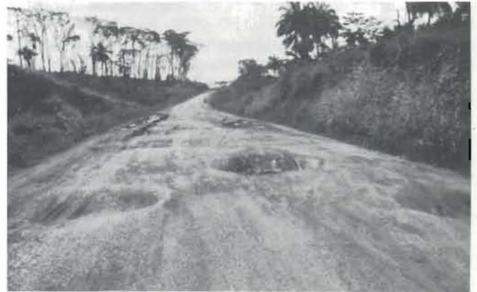
10: Vollständige Zerstörung einer bituminösen Straße durch mangelnde Unterhaltung in Sierra Leone
