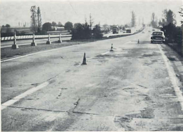
Abb. 73: Deckenzustand, insbesondere der Fahrspuren (AS Bruchsal)
