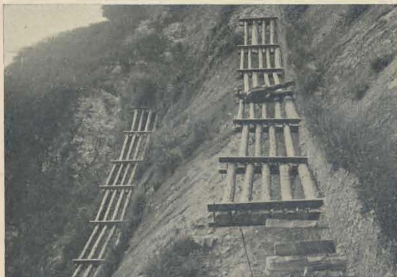
Fig. 16. Schneefußwände aus alten Eisenbahnschienen mit Zwischentagen von Rundholz am Sgawberg, 1000 m ü. M., ob Saalen (Glarus)
