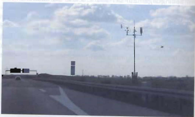
Abb.: Glättemeldeanlage an der A4
